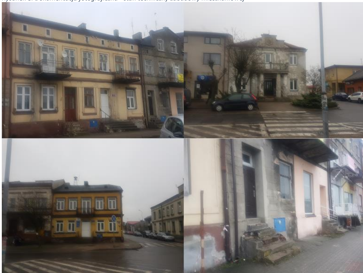
Rysunek 8. Dokumentacja fotograficzna - stan techniczny zabudowy mieszkaniowej
