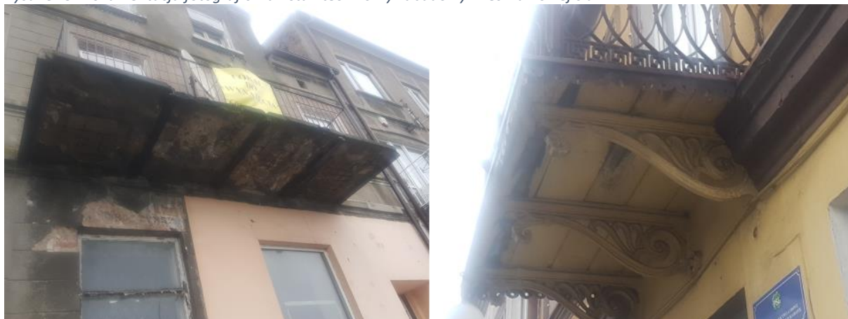
Rysunek 9. Dokumentacja fotograficzna - stan techniczny zabudowy mieszkaniowej c.d.
