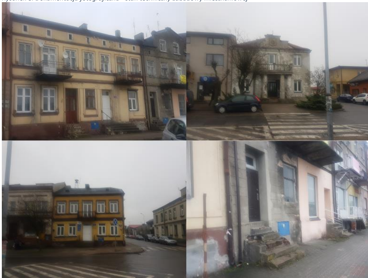
Rysunek 8. Dokumentacja fotograficzna - stan techniczny zabudowy mieszkaniowej
